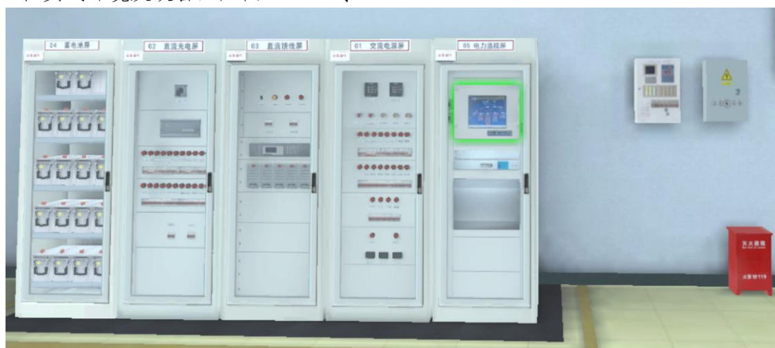
图 3-4-4 牵引降压变电所控制设备
